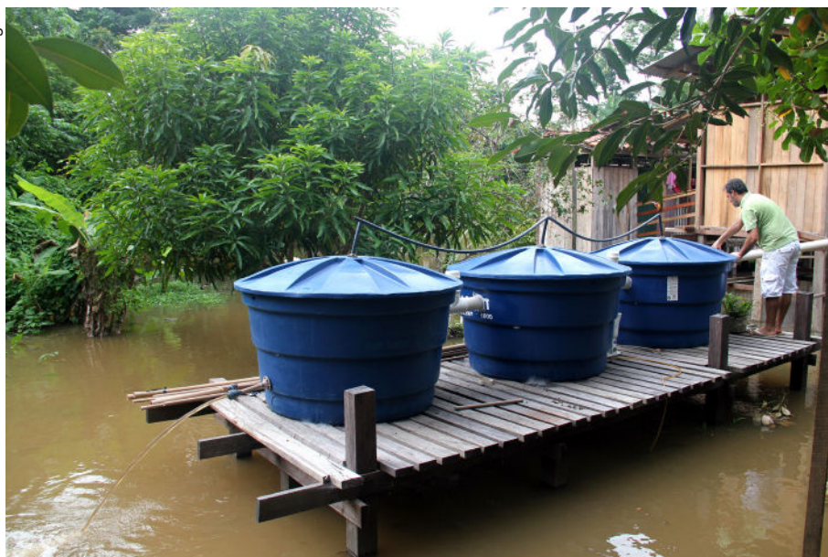
Figura 2. Fossa séptica biodigestora instalada na Ilha das Cinzas, Gurupá, PA, com três caixas de polietileno sobre o tablado de madeira, que é parecido com um jirau.
